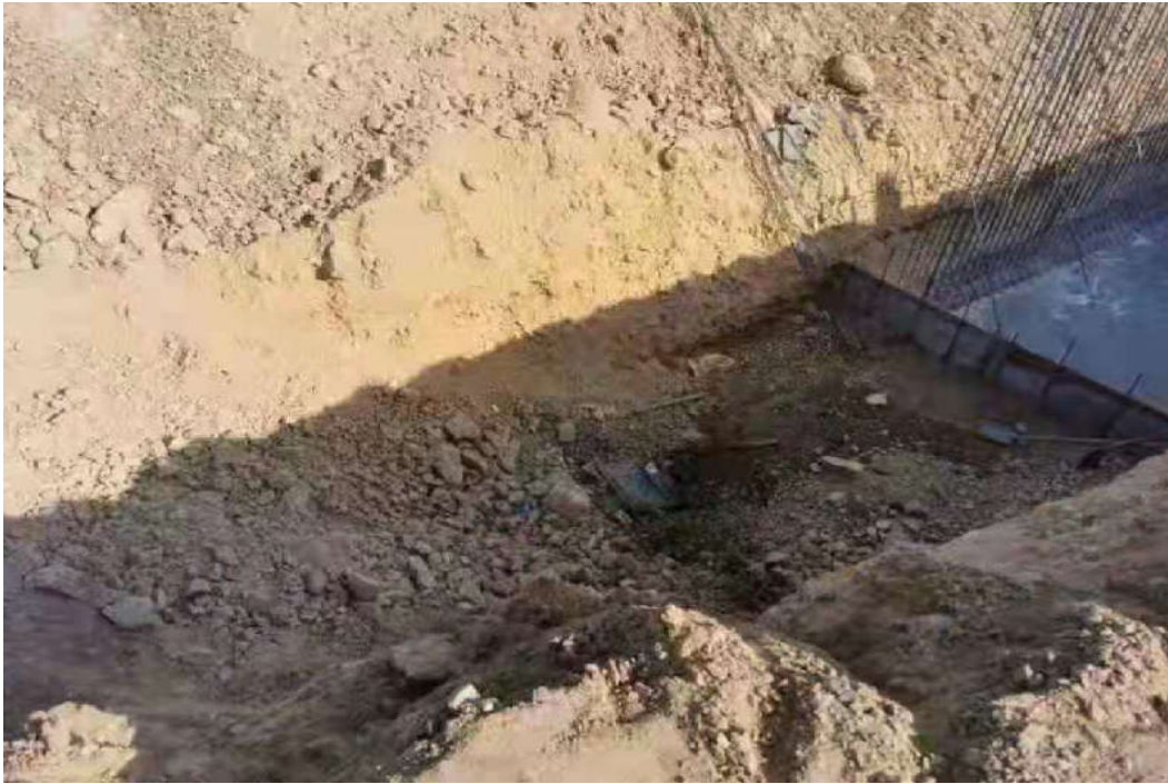
图 1 装载机翻落的边坡
